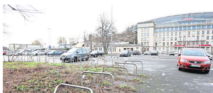
Laut Verkehrs- und Tiefbauamt ist die Asphaltdecke des Stadionvorplatzes an der Red Bull Arena brüchig. Am nächsten Montag beginnen die Sanierungsarbeiten. FOTO: ANDRÉ KEMPNER
